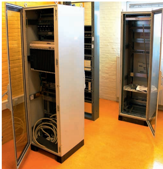
Momenteel wordt hard gewerkt aan de installatie van de PLC Interlocking
